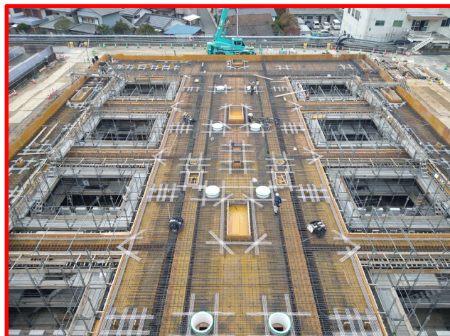
② 1系急速ろ過池
