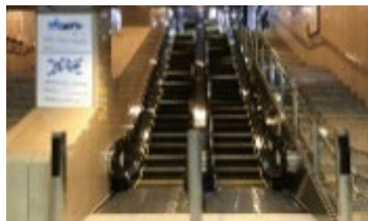
＜地下鉄博多駅エスカレーター＞
