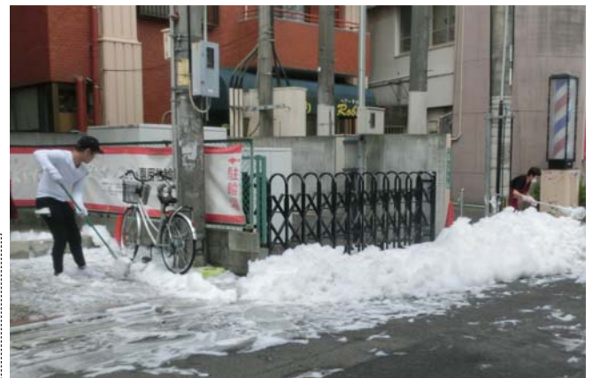
寒波により配管が破損し泡消火剤が流出した様子
