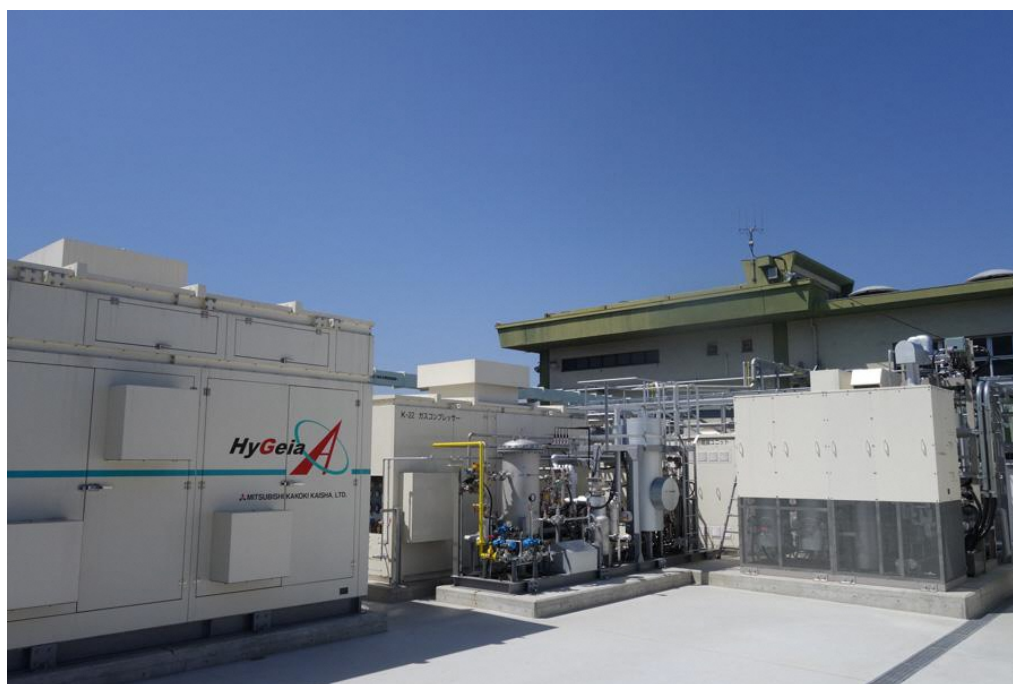
福岡市 水素製造設備
