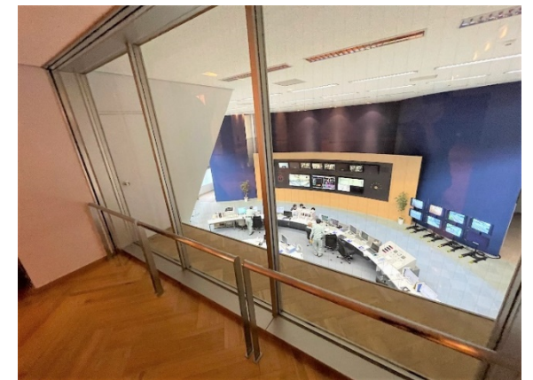
中央制御室(運転監視の様子) ※写真は臨海工場
