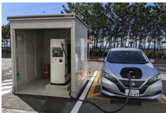
図9 電気自動車用 急速充電設備 49
