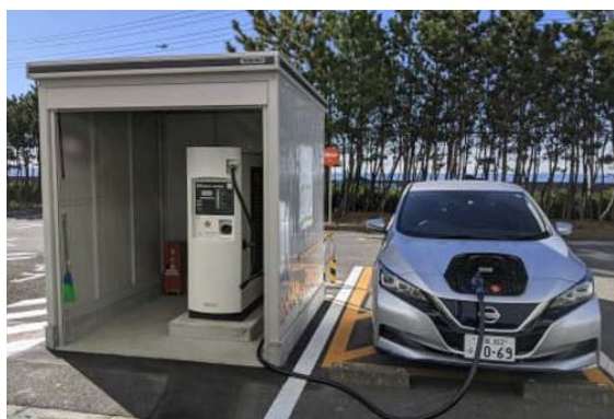
図 5-6 千葉市 新港清掃工場 電気自動車用 急速充電設備 4
