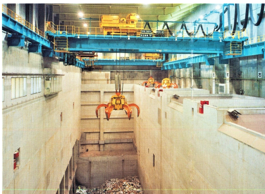
巨大なごみクレーンでの投入の様子
