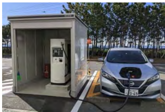
図9 電気自動車用 急速充電設備 49
