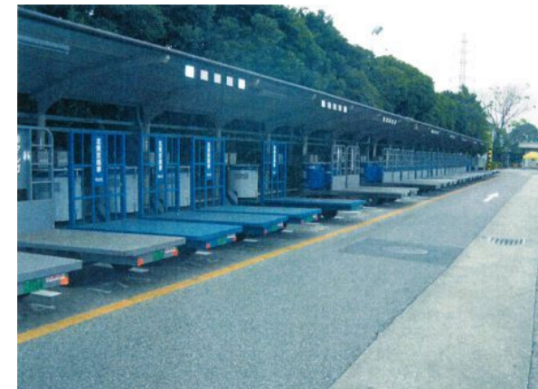
ターレット共同充電設備
