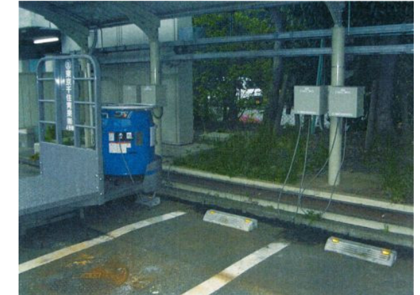
充電コンセントボックス
