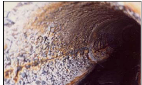
老朽化した下水道管内の状況
