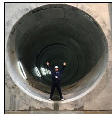
雨水管（内径5m）
