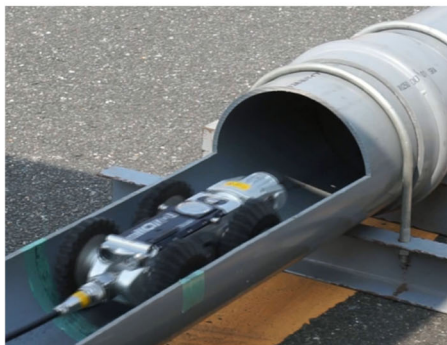
TVカメラによる劣化状況調査
