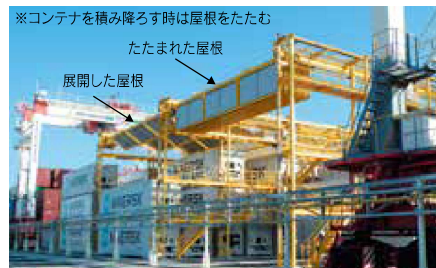
※2 リーフター設備 冷蔵、冷凍輸送コンテナへの電力供給設備
