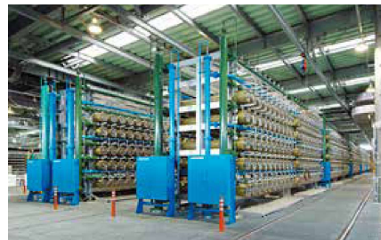
高圧RO膜設備
