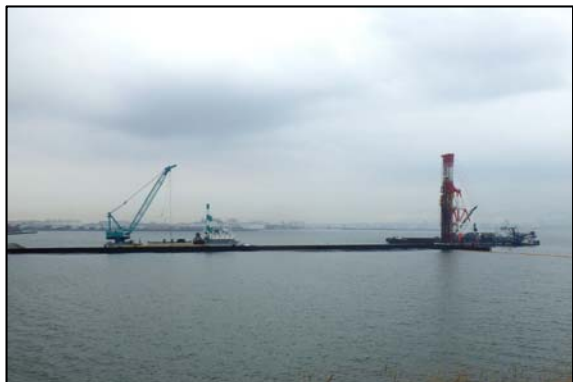
市3の2の2工区 仮締切堤築造 (盛土撤去(左側)・サンドコンパクション(右側))
