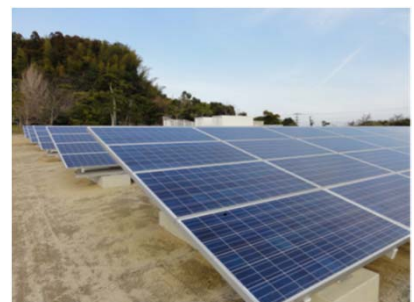
▲大原メガソーラー発電所
