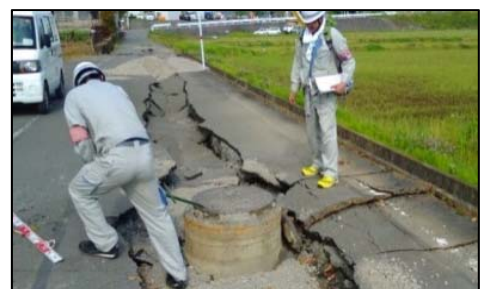
平成28年(2016年)熊本地震の被害 (益城町)
