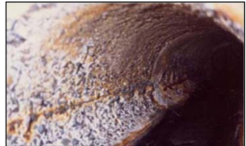
老朽化した下水道管内の状況
