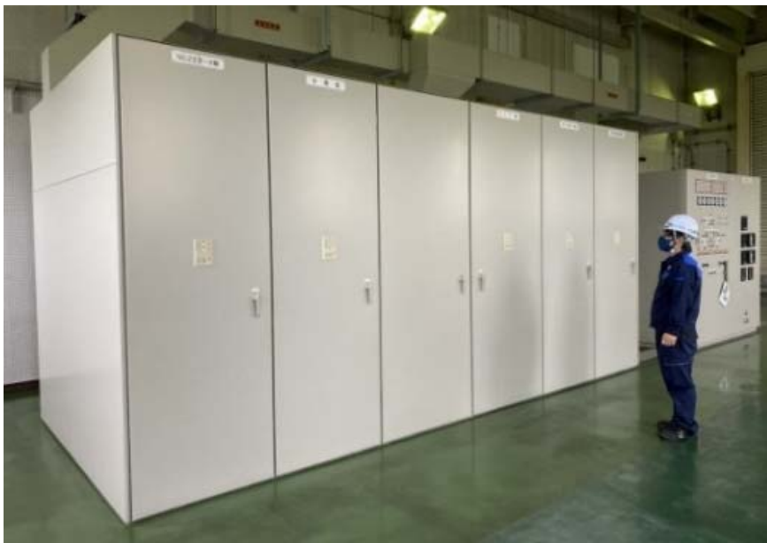
特別高圧配電盤（外観）
