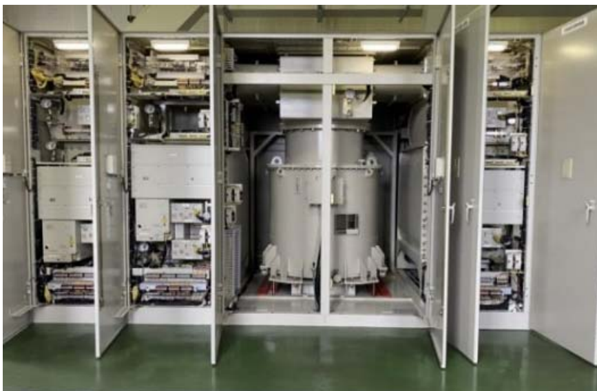
特別高圧配電盤（内部）
