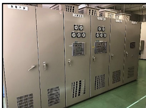
バッテリー電源を供給する盤
