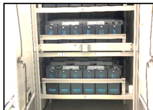
盤内部のバッテリー
