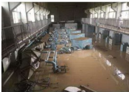
浸水被害を受けたポンプ施設
