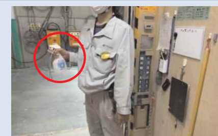
EVの操作盤等の消毒を徹底
