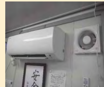
扇風機や換気扇とエアコンを併用
