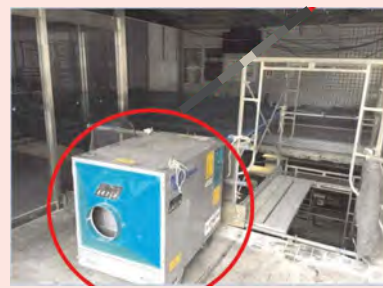
集塵機を設置し室内の換気を実施
