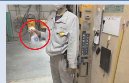
EVの操作盤等の消毒を徹底
