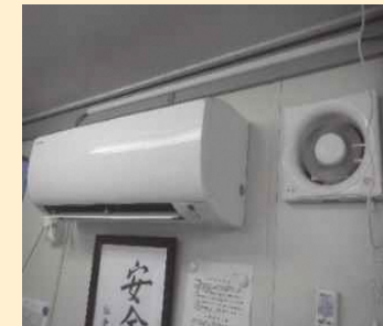
扇風機や換気扇とエアコンを併用
