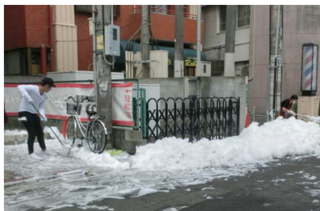
寒波により配管が破損し泡消火剤が流出した様子
