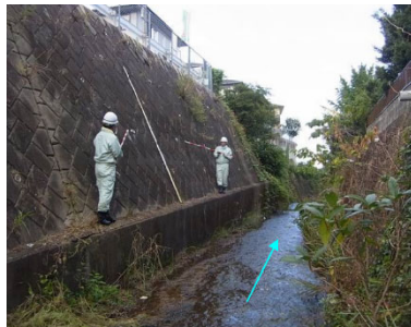
変状箇所の確認状況
