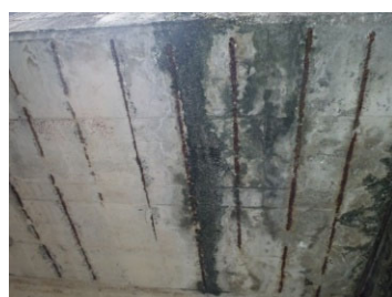
劣化状況（剥離）
