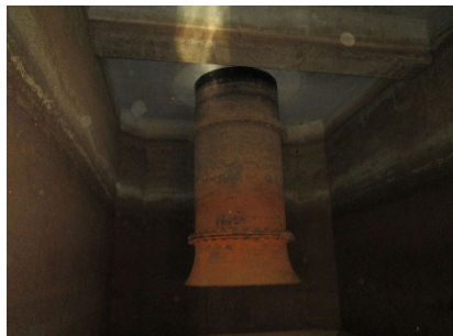
排水機場 揚水管劣化状況
