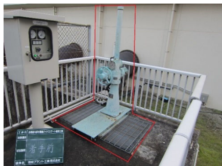
更新前（ゲート開閉機器）
