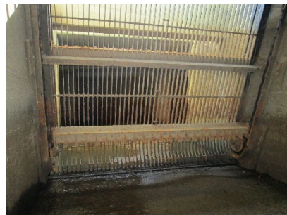
排水機場 除塵機劣化状況
