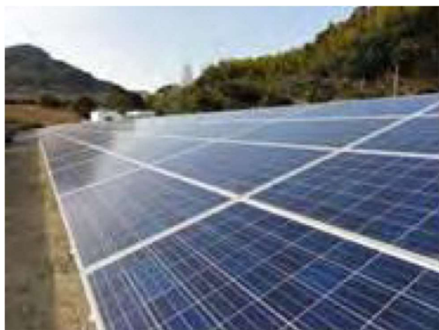
太陽光発電の事例（中田埋立場）
