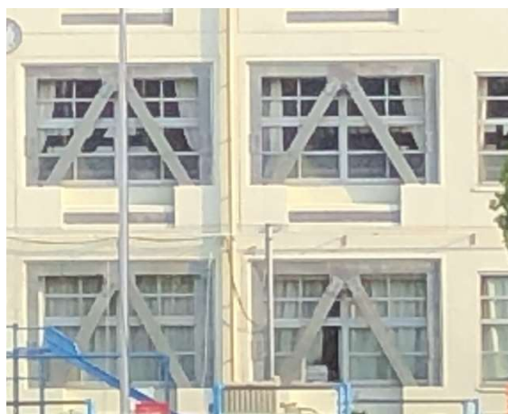
耐震化の事例（小学校）
