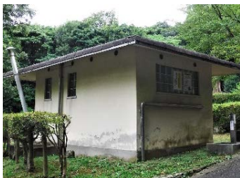
築45年が経過したトイレ
