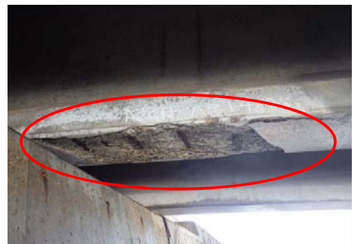
②【橋桁の鉄筋露出】
