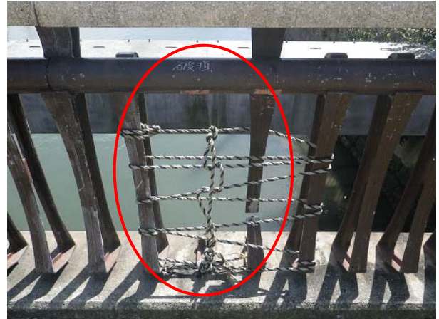
②【高欄の破損】
