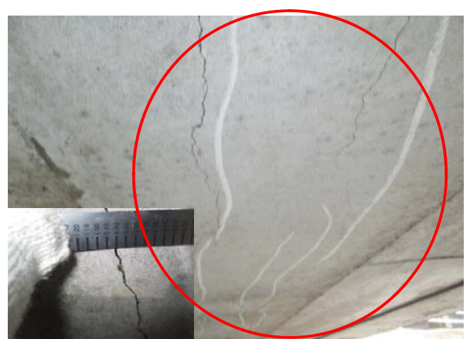
②【主桁のひび割れ】
