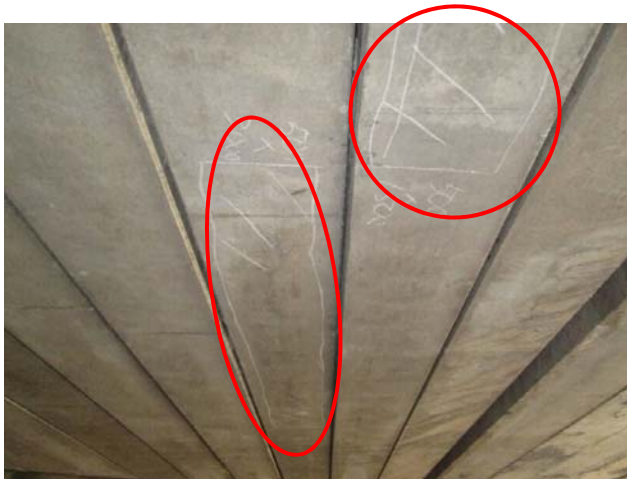
①【主桁のうき】
