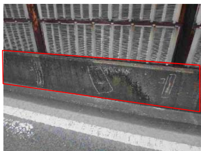
【防音壁の基礎部(壁高欄)の損傷】
