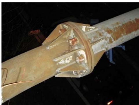
写真 3-7 損傷例：腐食 対策区分 I a
