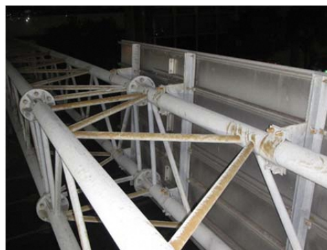
写真 3-8 損傷例：腐食 対策区分 I a
