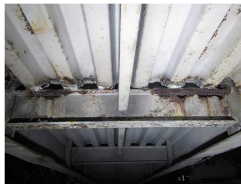
写真 3-5 損傷例：横桁の腐食 対策区分 III
