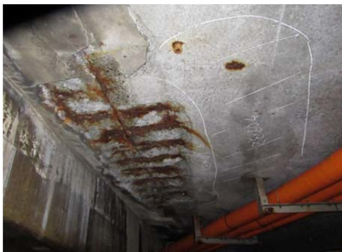
写真 3-9 損傷例：主桁の剥離・鉄筋露出 対策区分Ⅲ
