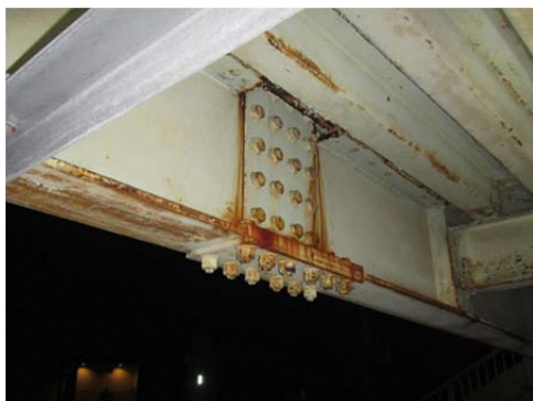
写真 3-4 損傷例：主桁の腐食 対策区分 II b
