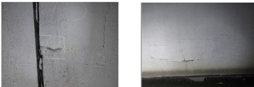
写真 3-2 損傷例：擁壁のうき 対策区分III
