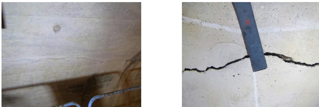
写真 3-1 損傷例：覆工板のひびわれ 対策区分 II b
