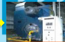
既設ボイラー
