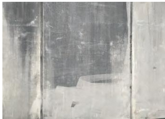
汚れが目立つ外壁
