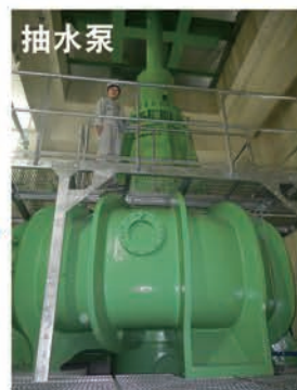
通过大型水泵将雨水抽取上来，排入河道
