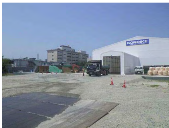
図 1.4-15 仮設洗浄処理プラント
