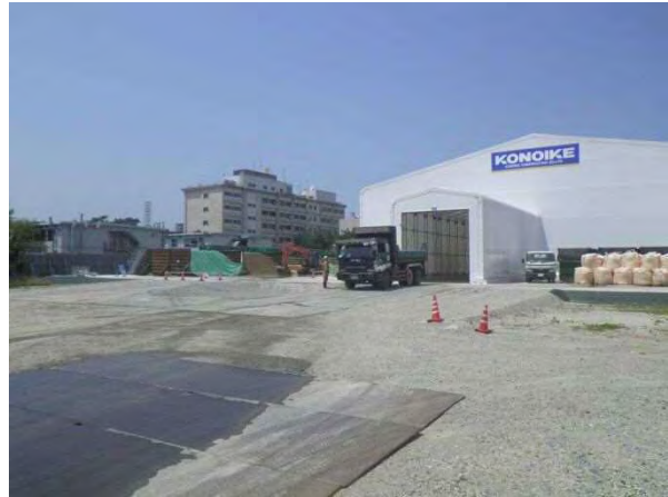
図 2.2-16 仮設洗浄処理プラント
