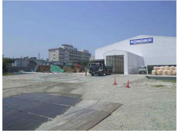
図 1.4-15 仮設洗浄処理プラント
