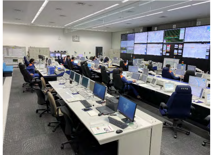
福岡都市圏消防共同指令センター
