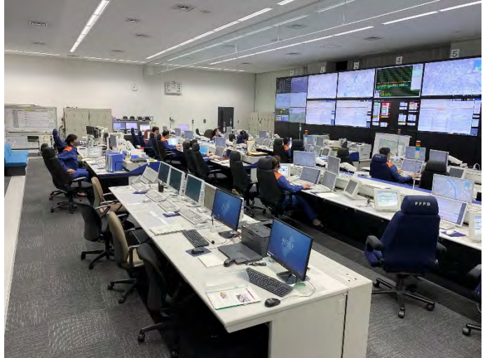
福岡都市圏消防共同指令センター
