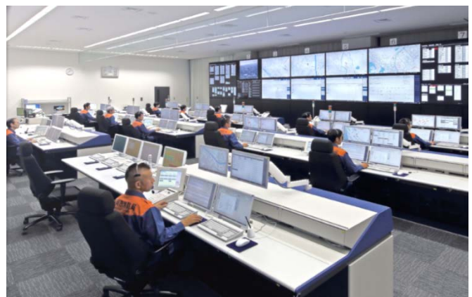
福岡都市圏消防共同指令センター
