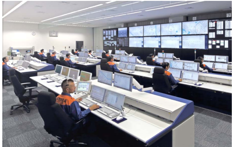
福岡都市圏消防共同指令センター
