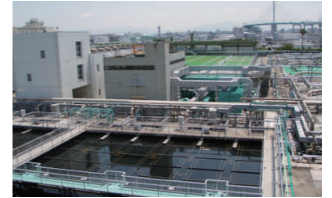
▲水処理センター
