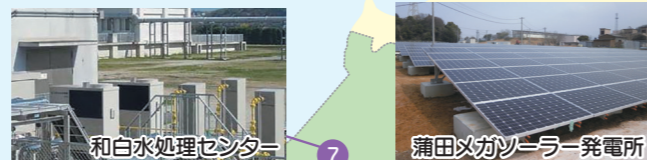
和臼水処理センター 7 蒲田メガソーラー発電所
