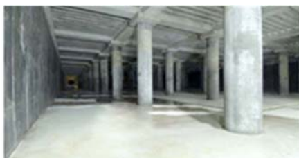
山王雨水調整池
