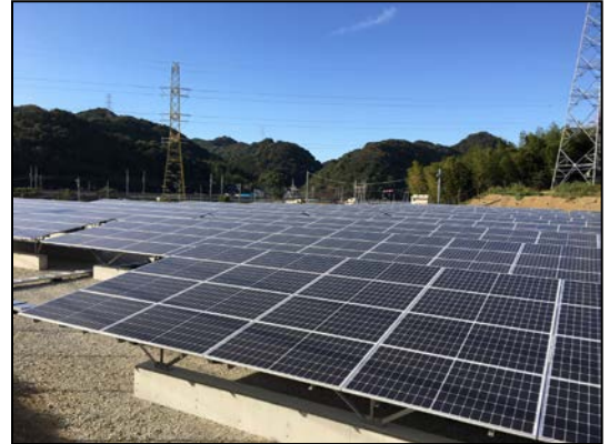
新設メガソーラー発電所（現地）
