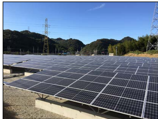
新設メガソーラー発電所（現地）
