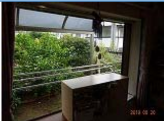
出窓家の中から出窓ガラスがない様子
