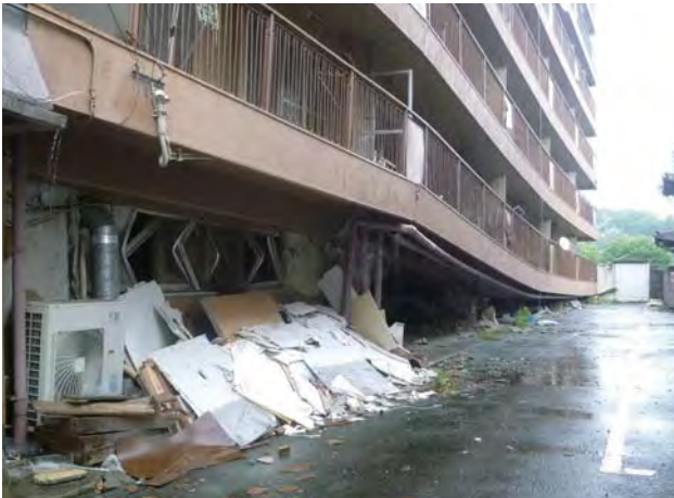
【写真：被害の様子】
