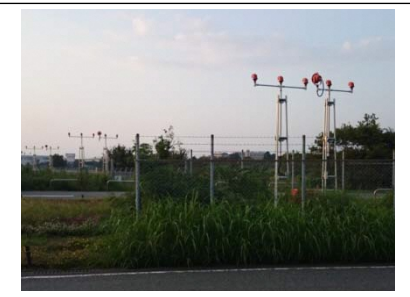
航空保安関係施設（進入灯）
