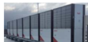
ガスエンジンマイクロ コジェネレーションシステム
