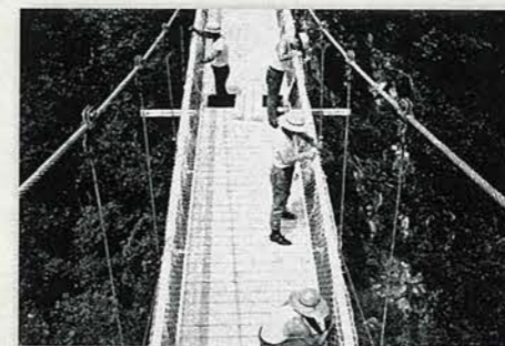
山から山へ懸かった空中の吊橋、トビ職たちが補強工事を急いでいる
